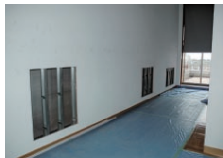
8階展示室の壁にも穴があけられ配管がむきだしに
